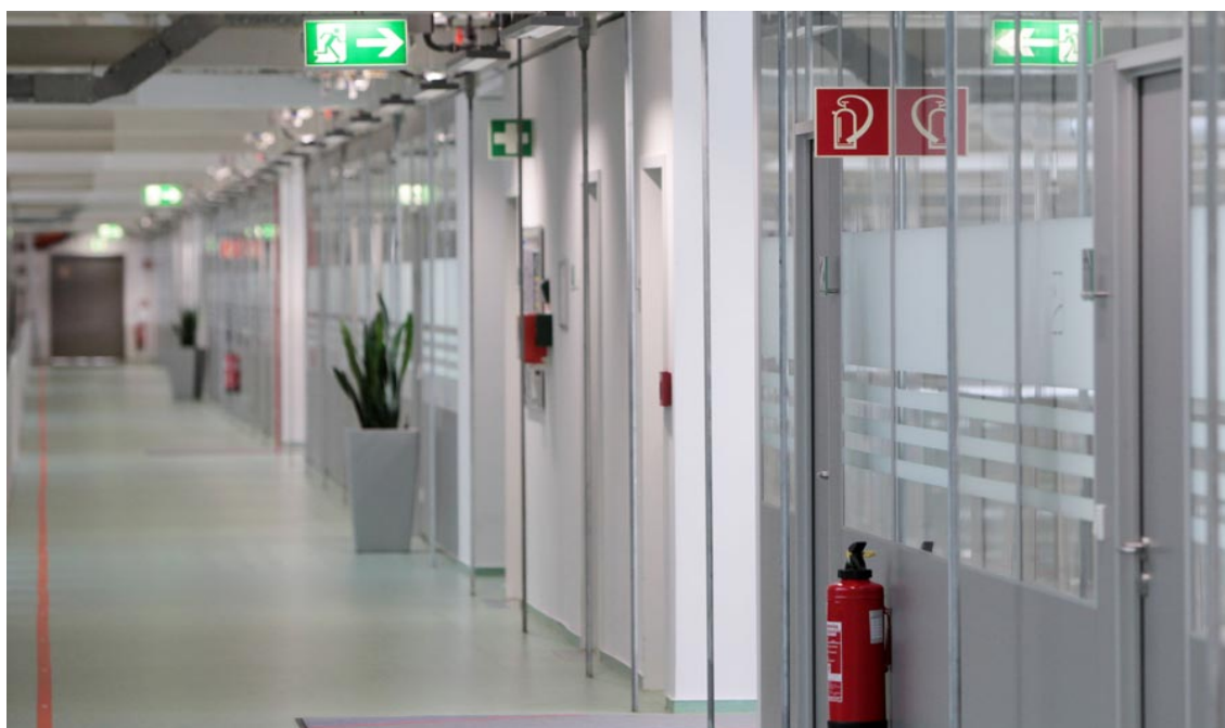
Eine Neuerung im betrieblichen Brandschutz: Feuerlöscher müssen möglichst innerhalb von 20 Metern erreichbar sein.
